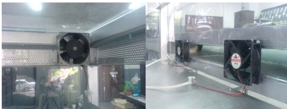
การติดตั้งชุดพัดลมพาอากาศร้อน
