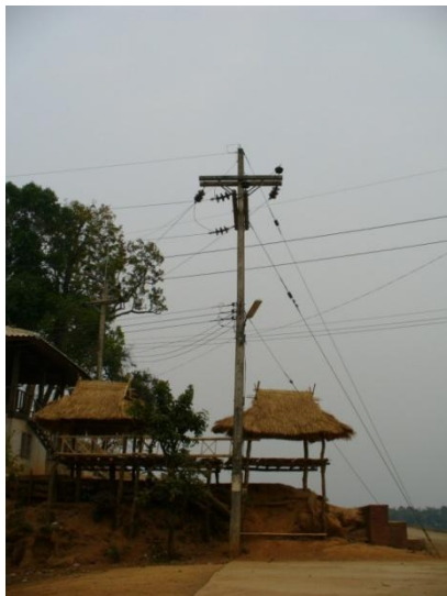
ภาพประกอบ 29 เสาไฟฟ้าบริเวณลานสาวกอด
