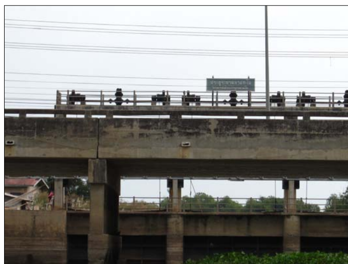
ภาพที่ 25 ประตูกันน้ำคลองบางคลี
