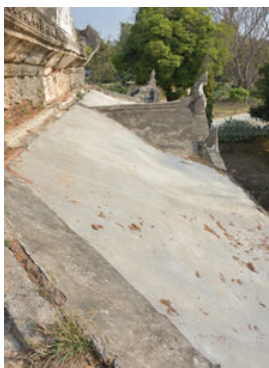
ภาพที่ 3.9 การซ่อมแซมหลังคาพระอุโบสถด้วยปูนซีเมนต์ที่มีความแน่นสูง
